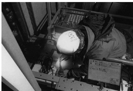
乗用エレベーター：かご上配線
